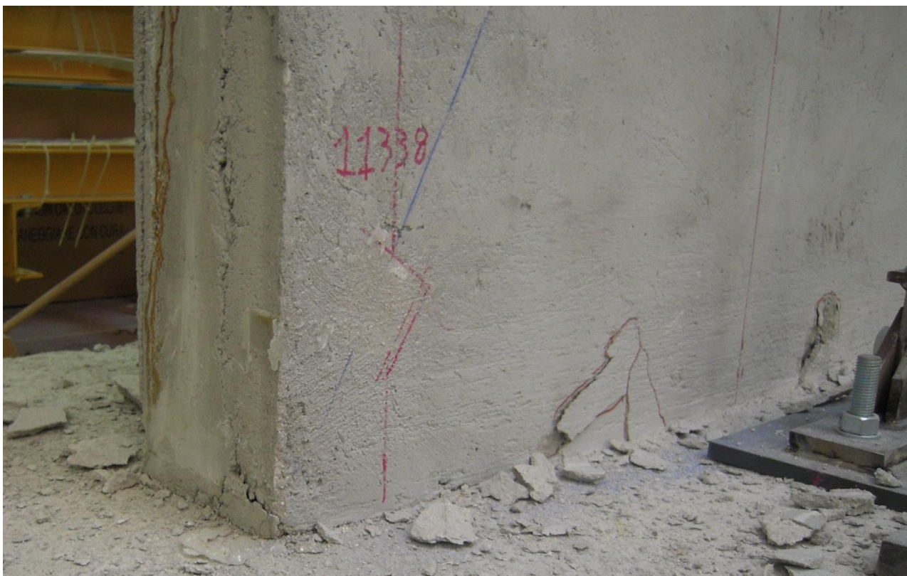
Figura 8-10 Stato di danneggiamento a fine prova alla base della parete destra con espulsione del copriferro dalle barre di collegamento in fondazione.
