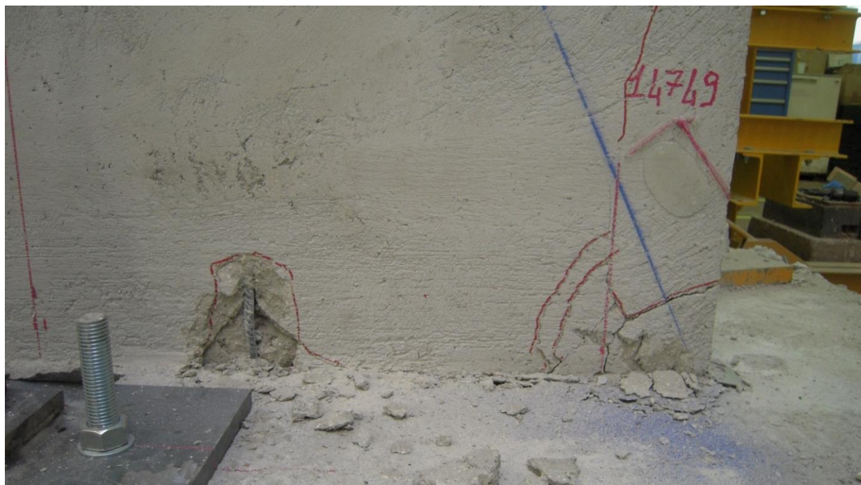
Figura 8-9 Stato di danneggiamento a fine prova alla base della parete destra con schiacciamento dello spigolo e sbandamento fuori piano della barra di collegamento alla fondazione.
