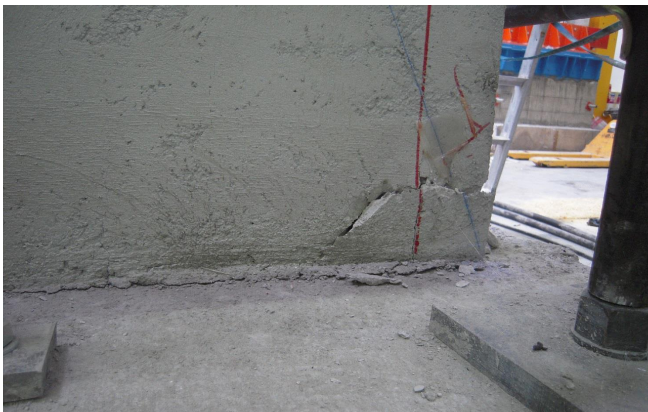
Figura 8-17 Stato di danneggiamento a fine prova alla base della parete sinistra, lato esterno, con schiacciamento dello spigolo.
