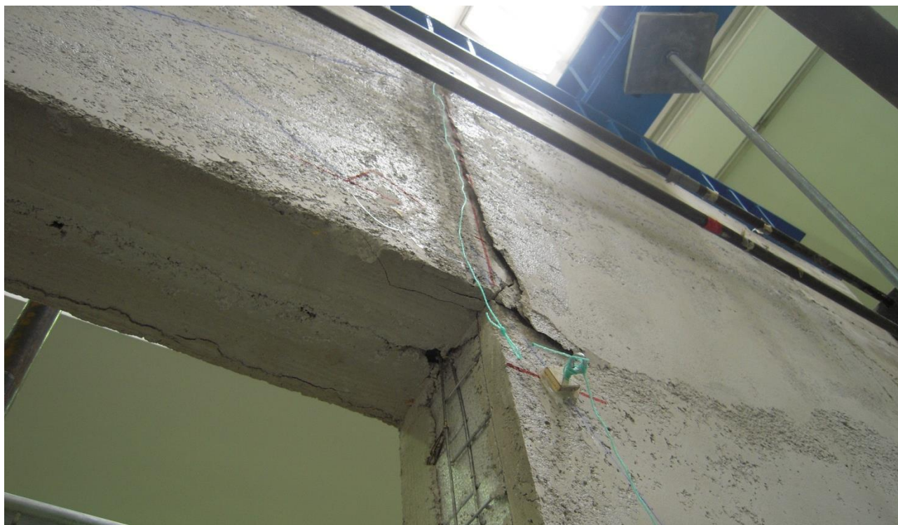
Figura 8-16 Stato di danneggiamento a fine prova della fascia di paino.
