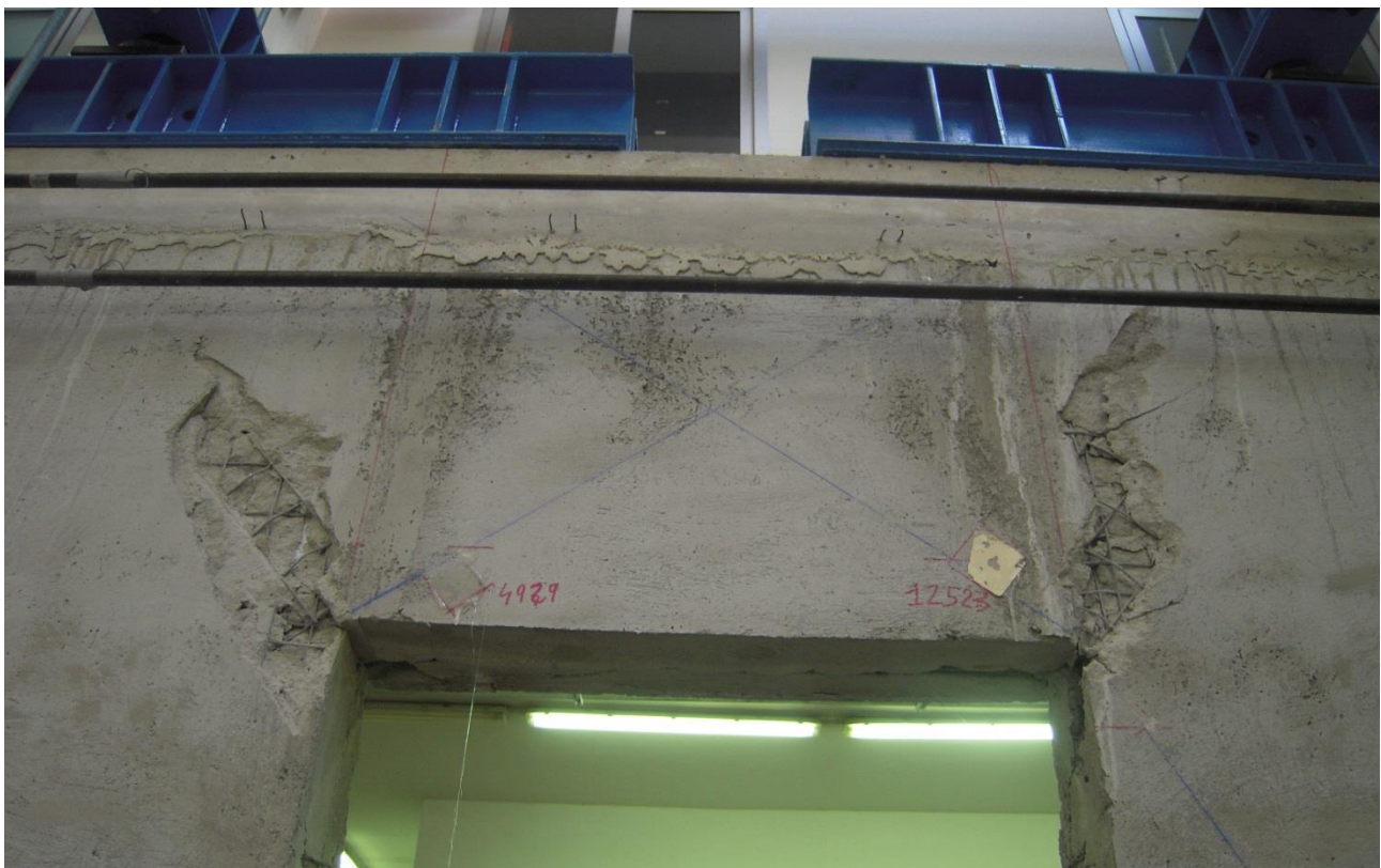
Figura 8-7 Stato di danneggiamento a fine prova della fascia di paino.
